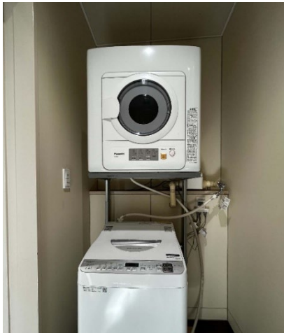
新設した乾燥機
